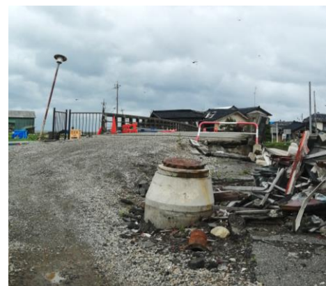
地面からせり出したマンホール
