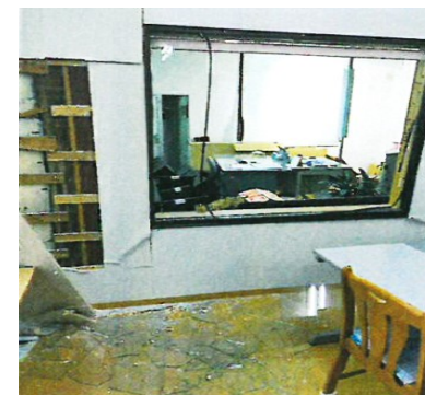
輪島市：ガラスが散乱する作業室
