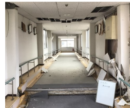
七尾市：廊下には大きな段差が。
