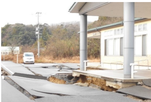
志賀町：地割れし陥没する敷地。
