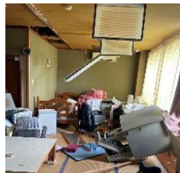
能登町：休憩室のエアコンも外れる。
