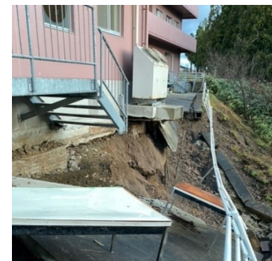
七尾市：施設の裏の地面が崩壊。
