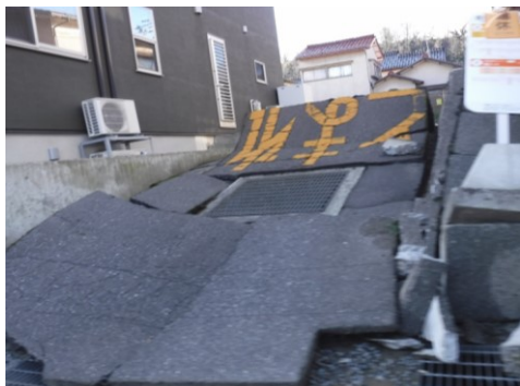
内灘町：液状化で道路が波打つ。
